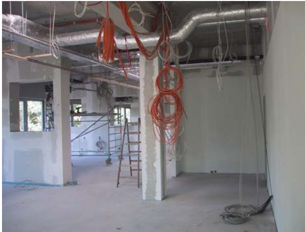
Technik und Lüftung im späteren Empfangsbereich...
